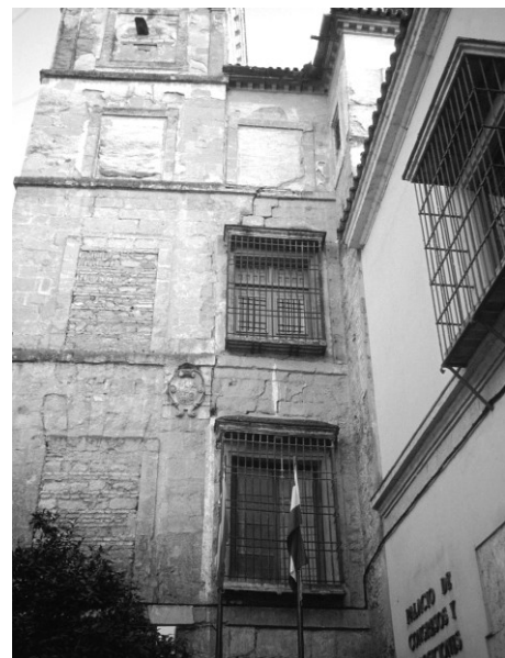
Foto 1: Las grietas se orientan hacia el foco del cedimiento (esquina)
