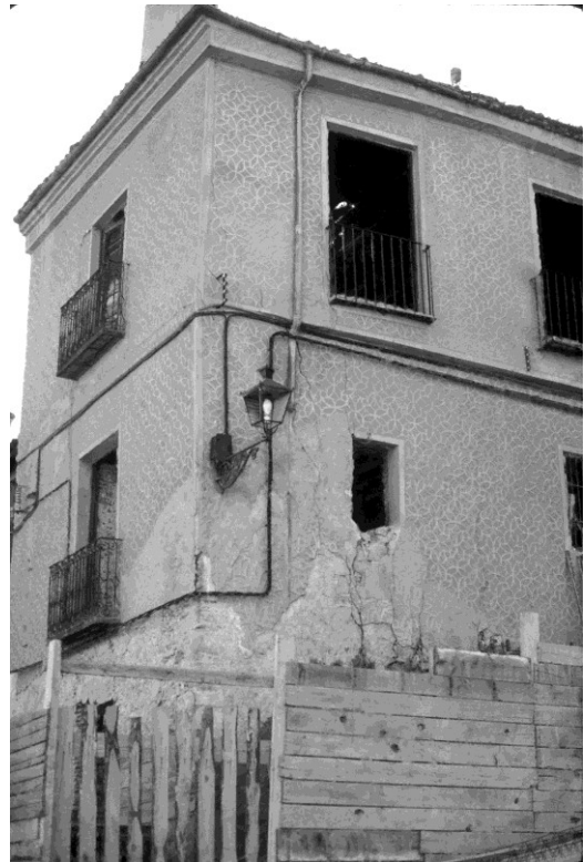
Foto nº 5: Pandeo en muros de fachada
