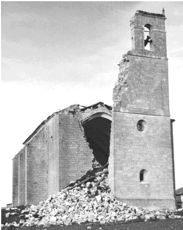
Foto nº 4: Derrumbe de una torre de iglesia por efecto de un giro
