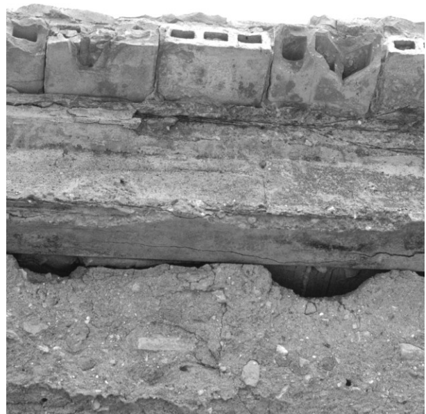
Foto nº 26: Rotura por oxidación de vigueta pretensada de H.A.
