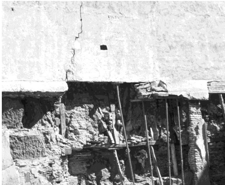
Foto nº 16: Ejemplo de inicio de parábola por cedimiento de una zona importante de medianería en edificio colindante a una obra en su inicio.
