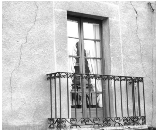
Foto nº 13: Rotura de parábola apuntada y sin cerra en la zona superior, como consecuencia de la apertura de un hueco
