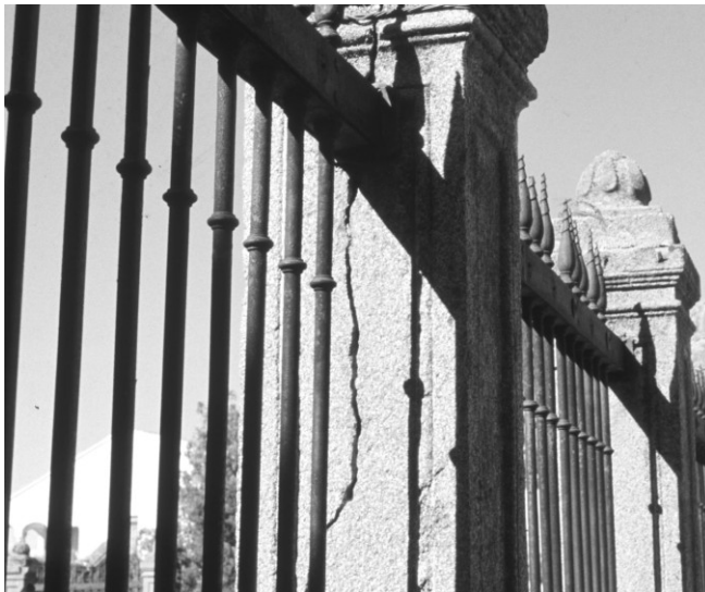
Foto nº 22: Columna de granito fisurada (Catedral de Zamora)
