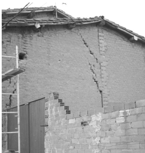
Foto nº 14: Ejemplo de cedimiento de muro de medianería en su primera crujía.
