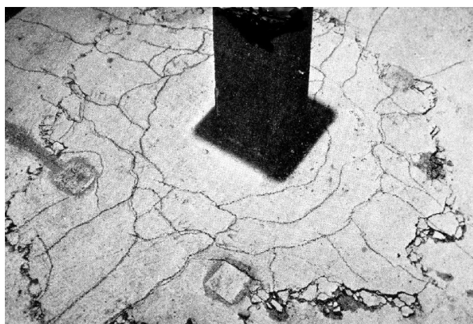
Foto nº 2: Rotura por punzonamiento. Se aprecian las fisuras por compresión (radiales) y las de tracción (concéntricas), hasta su rotura en forma de "tapón".
