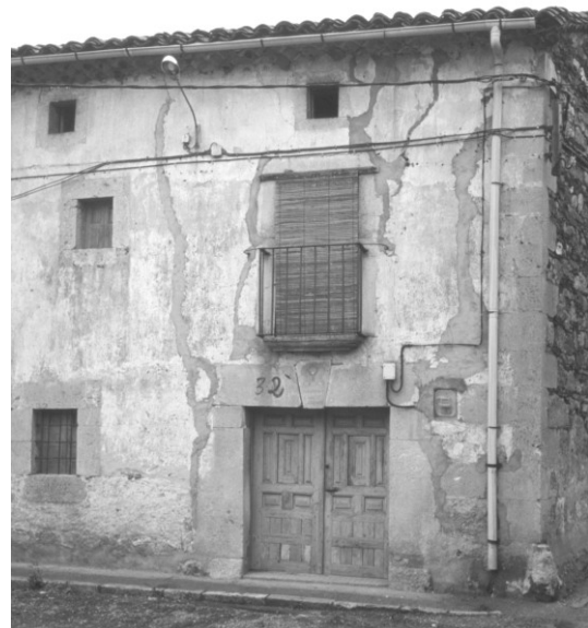
Foto nº 18: Efectos de las arcillas expansivas
