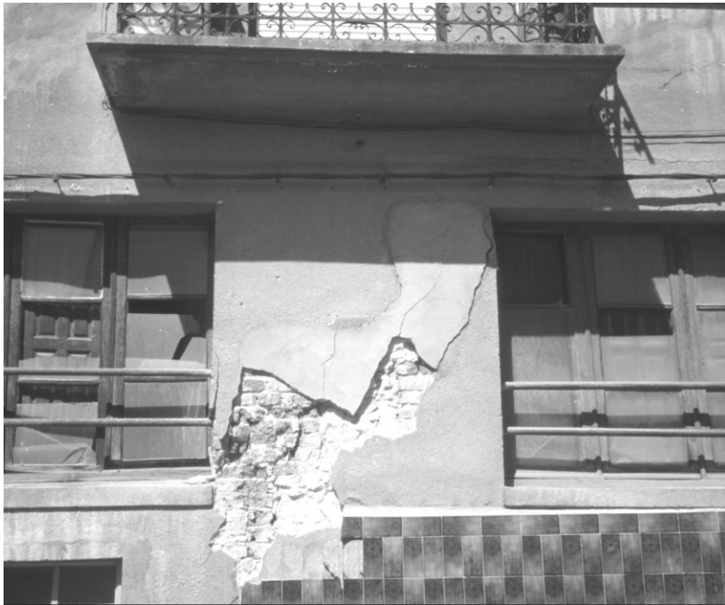
Foto 20: Rotura a compresión en machón de fábrica como consecuencia de una actuación previa para la apertura de hueco en fachada.
