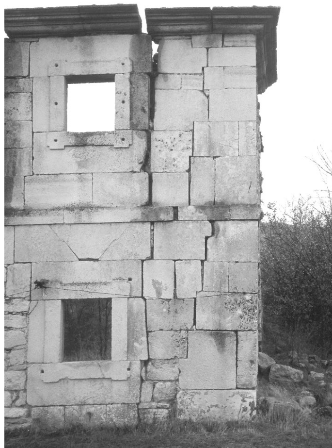
Foto n° 3: Efecto quebranto en una antigua fachada de sillería
