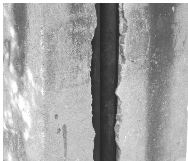
Foto nº 23: Rotura en protección de columna de alta tensión por oxidación de tubo
