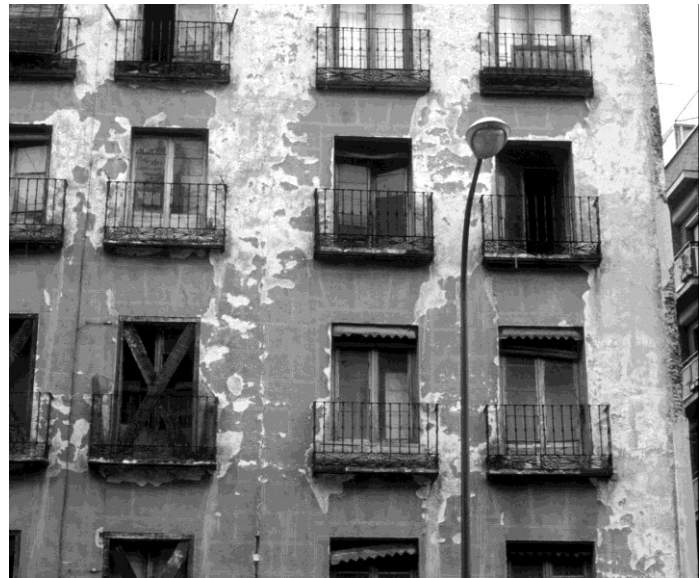
Foto nº 17: Grieta en fachada por corrimiento (machón 3º desde esquina)
