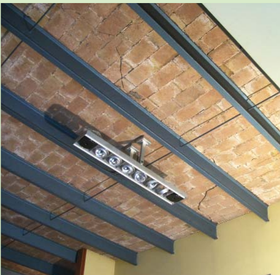
Ladrillos de los revoltones agrietados por soportar exceso de carga.
