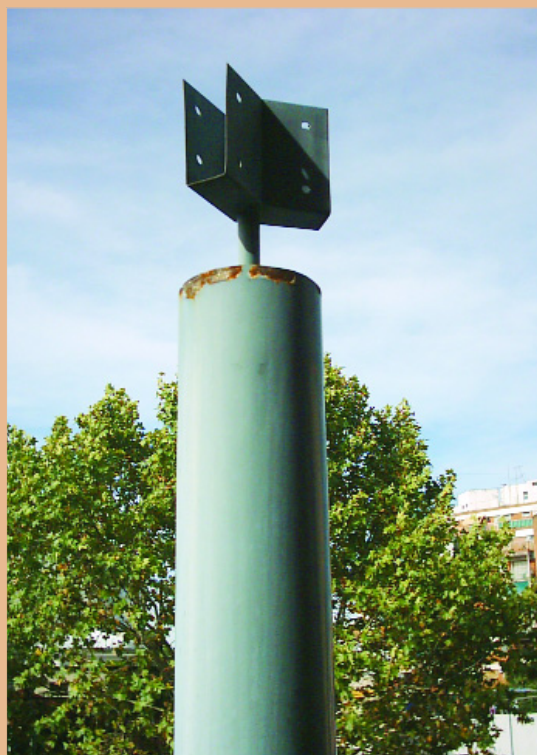
Inicio del proceso de corrosión de una estructura para pérgola al exterior.
