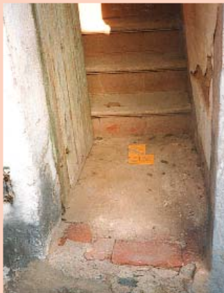
La ausencia de una buena terminación en las partes más transitadas, como en este caso la solía, lleva indefectiblemente a la progresiva destrucción del pavimento.
