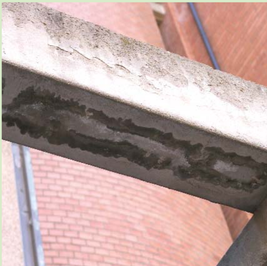
La imprevisión de goterones en este tipo de elementos al exterior provoca la acumulación de humedad y, si el hormigón no es compacto, las armaduras sufren el ataque de la corrosión en poco tiempo.
