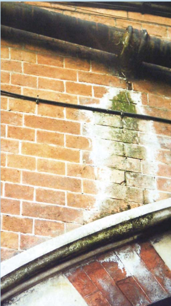
La pérdida en una conducción provoca manchas y la erosión de los materiales.
