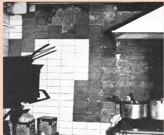
Pérdida de alicatado por exceso de humedad ambiente por falta de ventilación del local. Los morteros que se utilizaban antes absorbían más humedad y se hinchaban con mayor facilidad.
