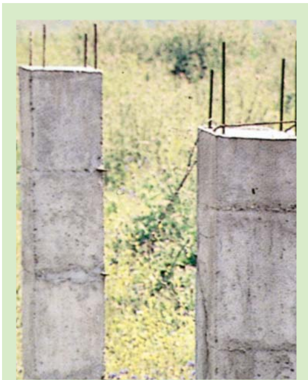
La armadura en espera de estos pilares es demasiado corta para producir un empalme aceptable con el pilar superior.
