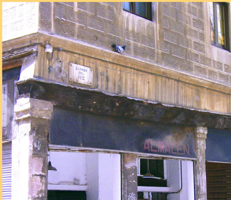
Viejas vigas de madera flechadas por la pérdida de resistencia mecánica con el paso del tiempo.
