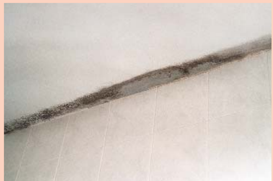
La humedad de condensación en este cuarto de baño mal ventilado ha favorecido el crecimiento de microorganismos (moho, hongos) y manchas en la pared.
