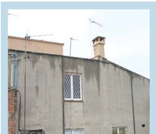
La falta de previsión o proyecto constructivo no puede evitar estos churretones que luego depositarán suciedad sobre la fachada.
