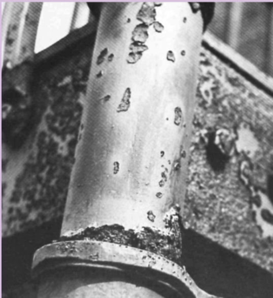
Corrosión por picadura de un elemento metálico.
