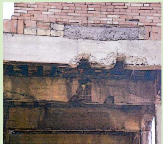
Rotura del hormigón por cesión de la viga al esfuerzo flector.
