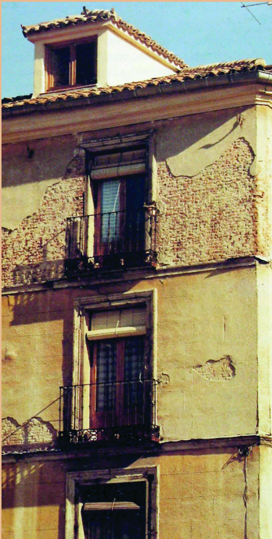
Pérdida del revoco de fachada. Los ladrillos quedan a la vista y expuestos a la humedad y erosión atmosféricas
