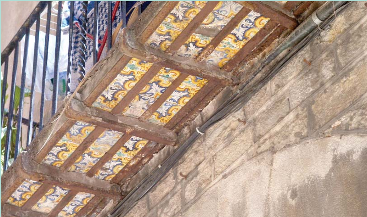
La corrosión en balconeras y salientes metálicos no sólo afecta estructuralmente a dichos elementos sino que también provoca manchas en la fachadas.
