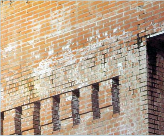
Una filtración interna ha desencadenado la aparición de eflorescencias en este muro.
