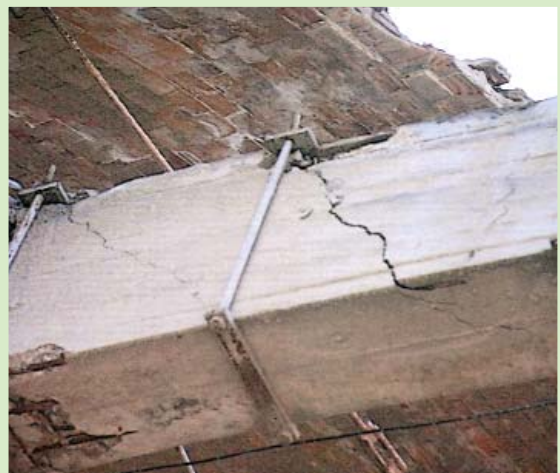
Fisura característica por exceso en el esfuerzo de corte.
