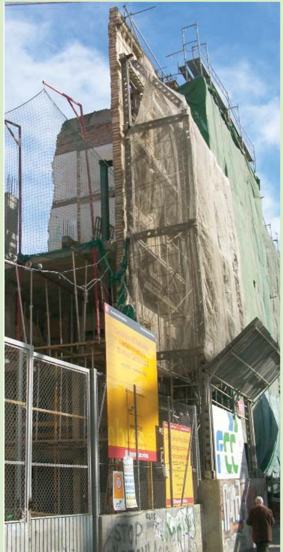
Dos casos de arriostramiento metálico de fachadas. Los forjados y muros interiores han sido quitados por una operación de reciclado del edificio y, por lo tanto, el muro portante exterior ha perdido parte de su rigidez.
