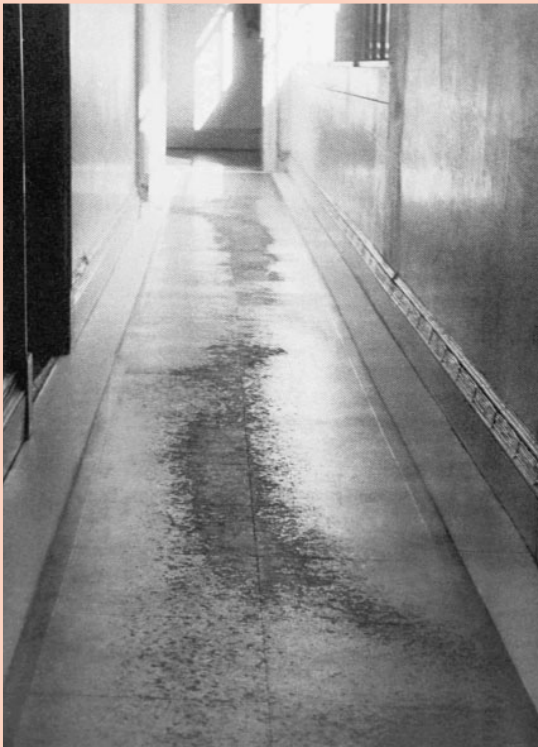
Pavimento erosionado por el uso. La intensidad del uso es una de las variables fundamentales en la elección de un pavimento.
