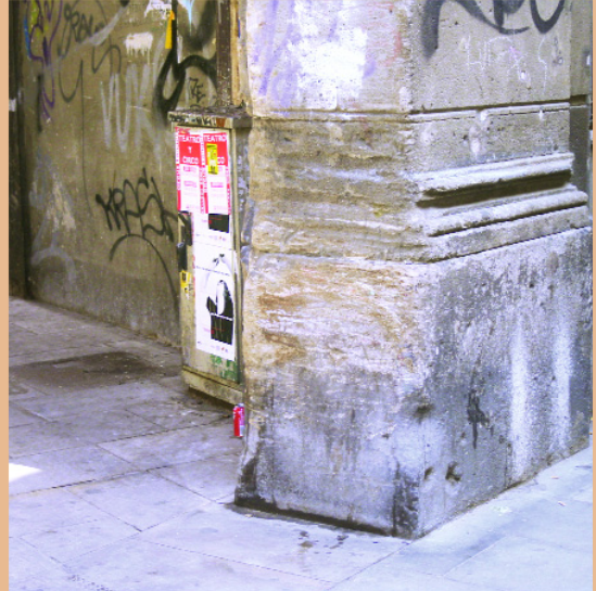
Ejemplo básico de erosión mecánica de un elemento constructivo al roce permanente de vehículos y personas.
