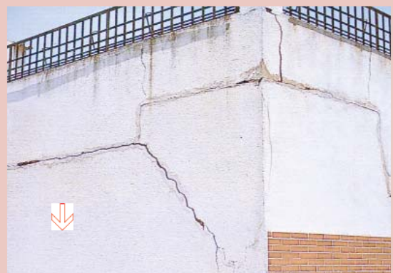
La parte indicada ha descendido con respecto al resto del muro produciendo la grieta.
