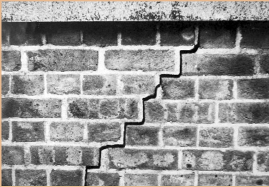
Grieta por asiento diferencial en un muro de obra de fábrica. La parte a la derecha de la grieta ha descendido con respecto a la otra.
