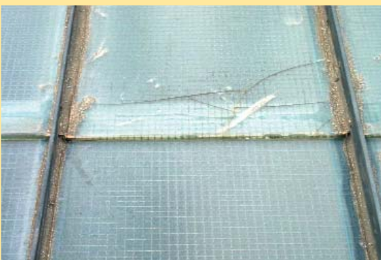
Estos cordones selladores de siliconas se han resecaado y endurecido, impidiendo las dilataciones del vidrio y produciendo en consecuencia su resquebrajamiento.
