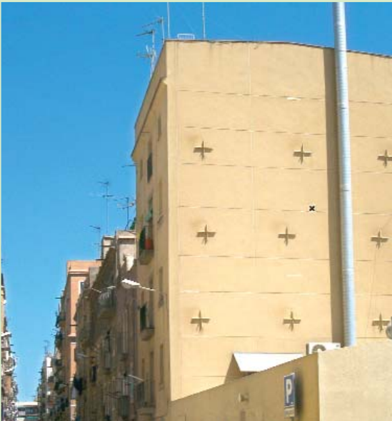
Las cruces que se ven en esta medianera corresponden a tensores metálicos insertos en los forjados para aumentar la rigidez del conjunto edilicio. Esta operación denota la fatiga de la estructura original.
