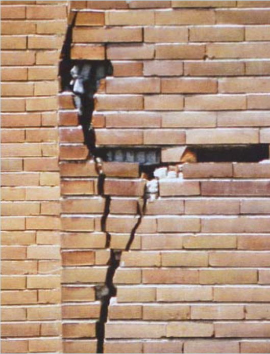
La dilatación térmica de la estructura portante de hormigón armado ha logrado romper el muro de ladrillos debido a la inexistencia de juntas de dilatación.
