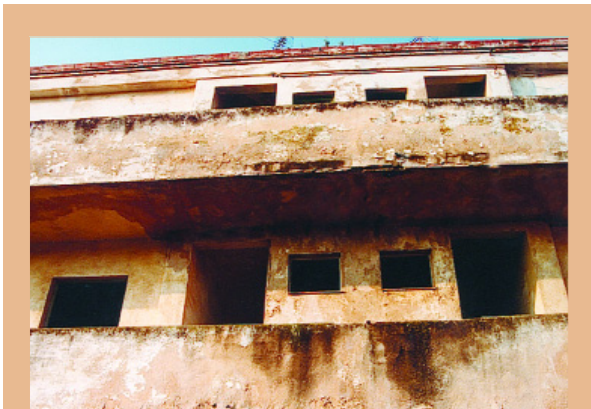
Deterioro muy avanzado de una fachada atacada por múltiples humedades.
