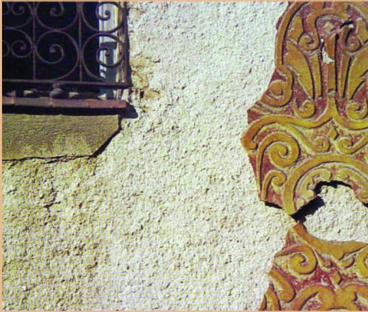
Pérdida de la capa exterior del revoco de fachada. Es este caso se trata de un revoco del tipo esgrafiado.
