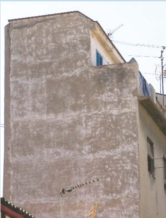
La misma grieta por la acción térmica en fachadas contiguas de un mismo edificio..
