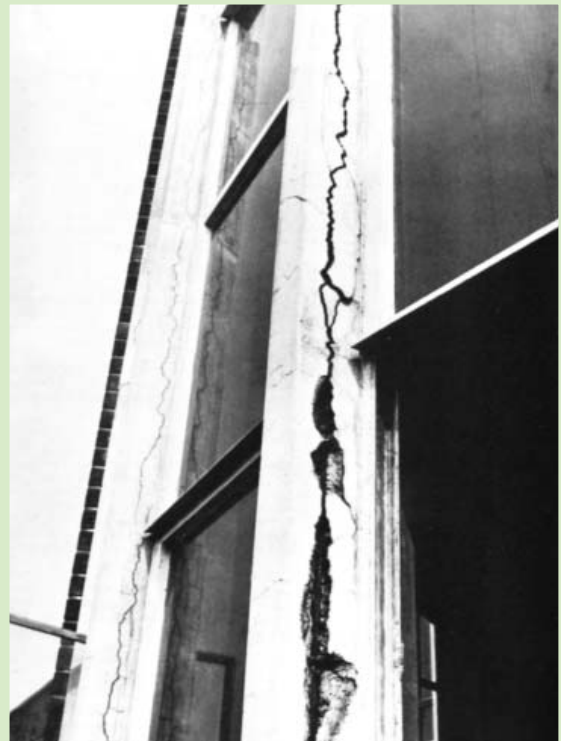
La corrosión de las armaduras ha provocado el resquebrajamiento del hormigón en estos elementos de fachada.
