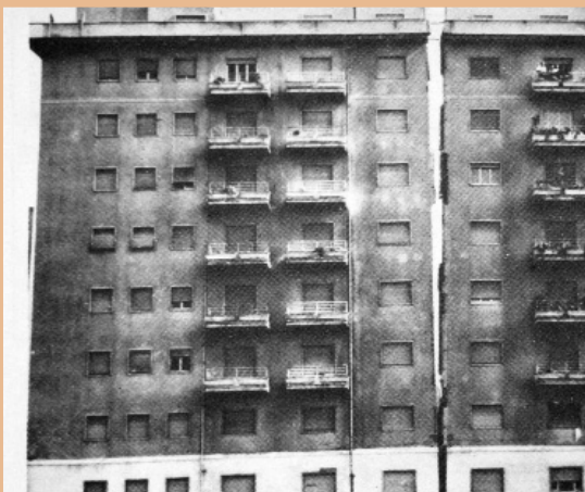
Asentamiento diferencial. Parte de la fundación de la mitad de este edificio ha descendido provocando el desdoblamiento del mismo y la apertura de la junta constructiva.
