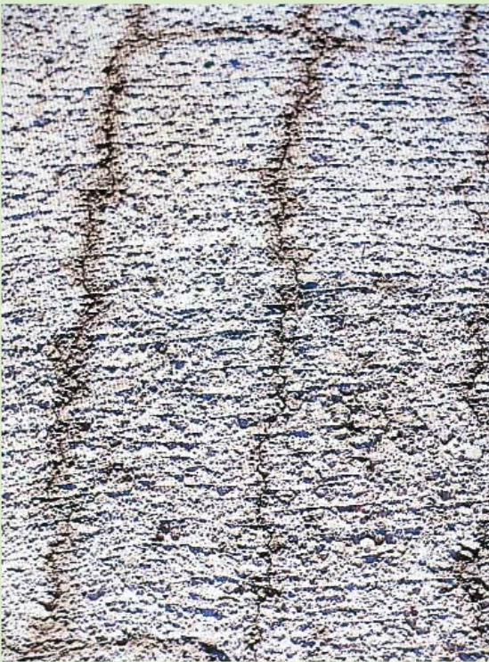
Fisuras características debidas a la retracción del hormigón armado.
