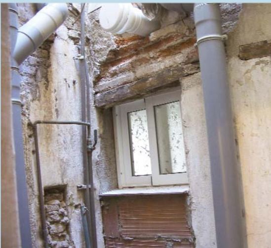
Un planteo deficiente en lo constructivo y en las instalaciones acarrearán múltiples problemas. Este hueco ventilador se halla atestado de conducciones y su mantenimiento se torna muy difícil.
