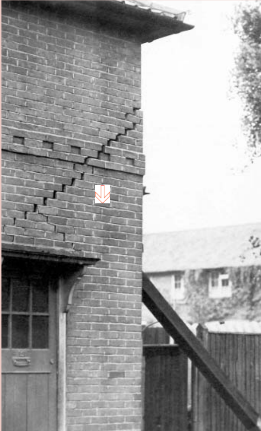
Una parte del muro descende mientras que el resto de la edificación permanece inmóvil.
