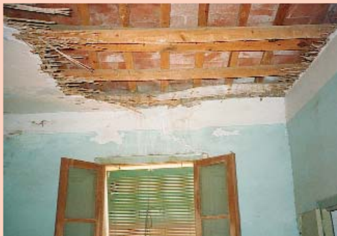
Destrucción de cielorraso.
