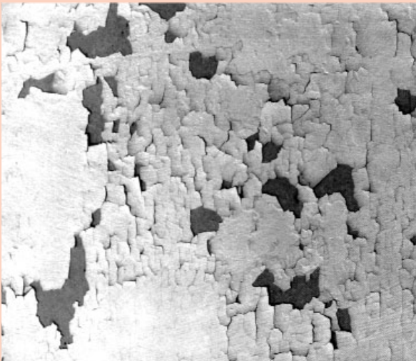
Pintura de base acrílica descascarada.
