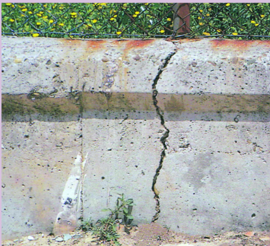
Claro ejemplo de la expansividad de un elemento con corrosión. El hormigón se ha fisurado y esto permitirá la entrada de agua y una corrosión más rápida aún.
