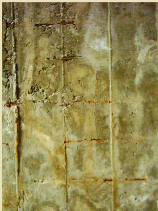
Armaduras con corrosión.
