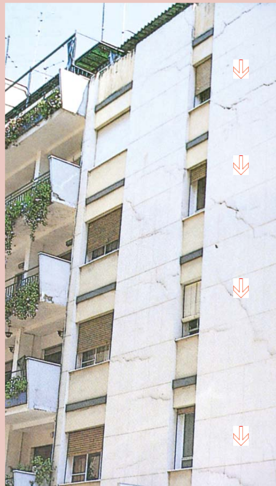
Los asientos diferenciales pueden producir muchas grietas situadas a intervalos regulares y con la misma dirección. Éstas nos indican las partes más sensibles del edificio. ⚠️ asiento.
