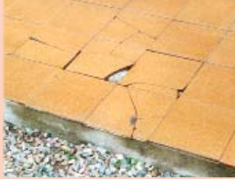
La falta de juntas en pavimentos al exterior indefectiblemente conduce al levantamiento de las piezas.
