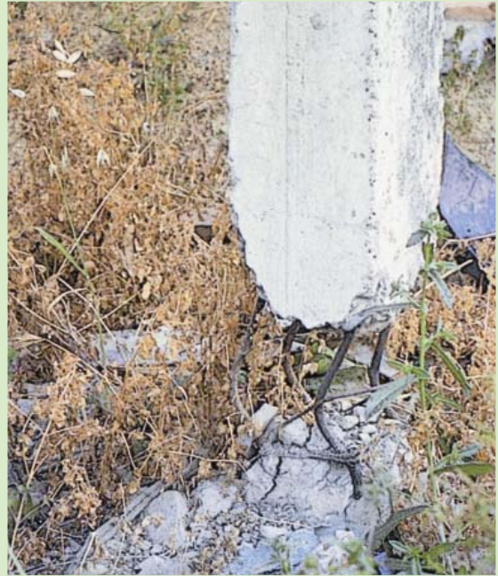
Cesión de un pilar con pérdida de material.
