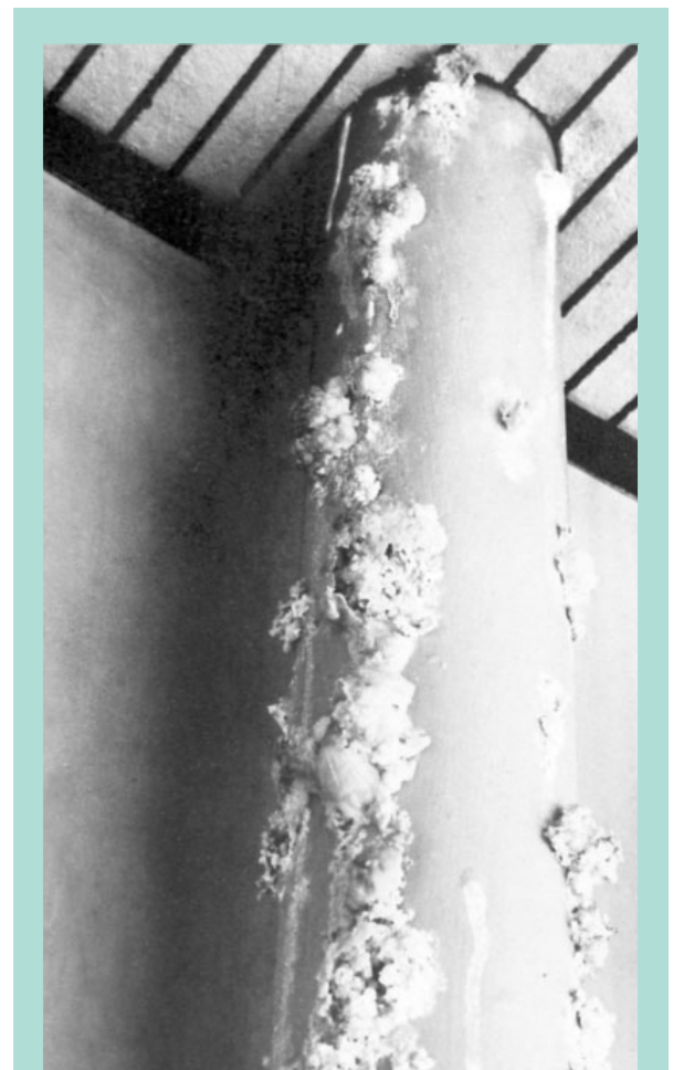
Filtración de agua en la cubierta con caída por la columna. La permanencia de la humedad ha favorecido a su vez la aparición de una flora de hongos.
