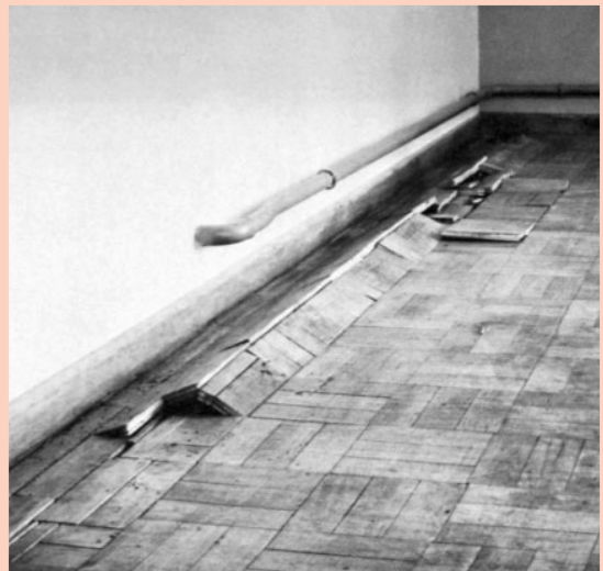
En interiores es el sustrato o soporte del pavimento el que se mueve en la mayoría de los casos. Ya sea por asentos o movimientos higrotérmicos hay que prever juntas de movimiento perimetrales del pavimento.
