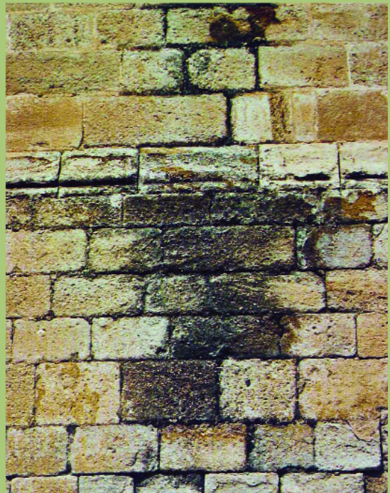
Manchas en muros de piedra. Depósito de hollín en la parte que no recibe el lavado de la lluvia (arriba), y erosión por filtración de humedad (abajo).
