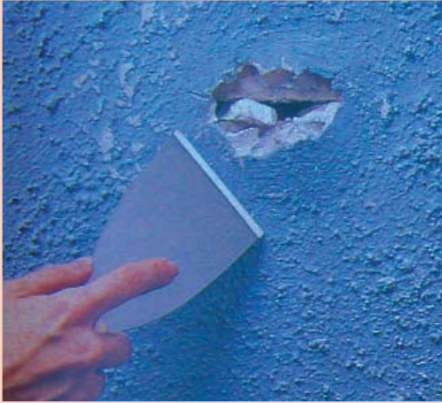
Raspe el picado y la pintura desconchada.
