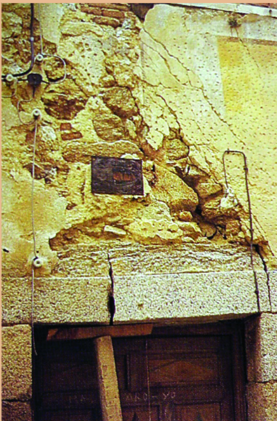
Por falta de mantenimiento las conducciones rotas dentro de este muro no han sido reparadas provocando, con el tiempo, a la destrucción del mismo.
