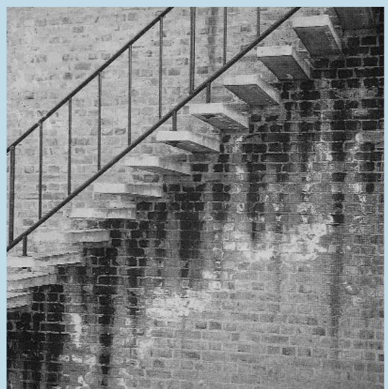
Distintos churretones en diferentes situaciones constructivas: cornisas, balcones y escalones.
