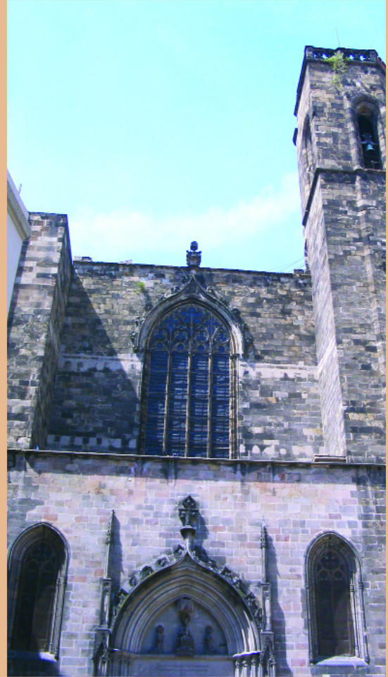
En obras de piedra a la vista el distinto origen o tratamiento de las piezas utilizadas (veta, cantera, corte) produce distintos grados de absorción y retención de suciedad.
