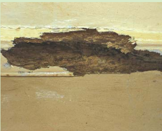
Ataque xilófago en una viga de madera interior.
