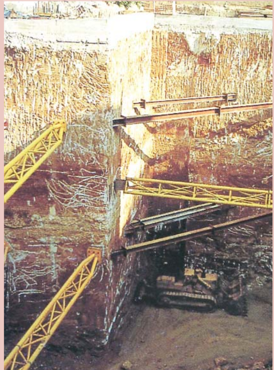
El método es semejante al de la fotografía anterior, sólo que en este caso se trata de apuntalar las paredes de la excavación de cimientos. Aquí el riesgo puede verse incrementado en el caso de suelos expansivos y napas freáticas superficiales.
