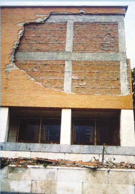
La imposibilidad de dilatar de este tabique de fachada ha provocado no sólo su rotura sino también su posterior colapso.
