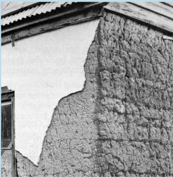
Pérdida de revoco en un muro de tierra. Por el grado de absorción del material del muro, el revoco cumple una función vital en la aislación del conjunto.
