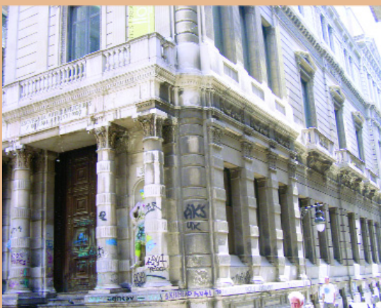
Pintadas (grafitis), manchas de orín, deposiciones, rayaduras son algunas de las lesiones a edificios propias del vandalismo.
