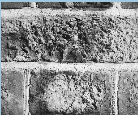
Erosión física de un ladrillo de baja calidad por haber sido cocido de forma incorrecta.
