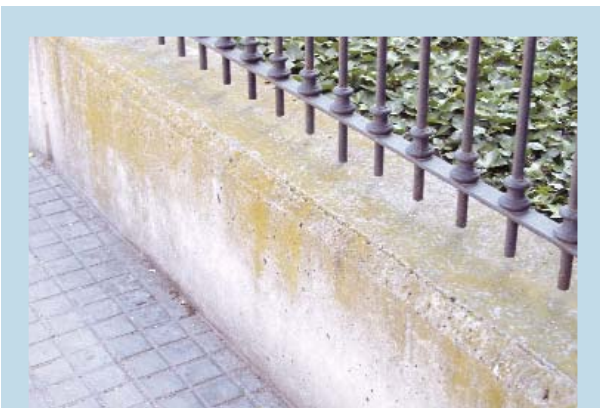
La porosidad de este hormigón expuesto a la intemperie provoca la retención de humedad y la aparición del "verdín".
