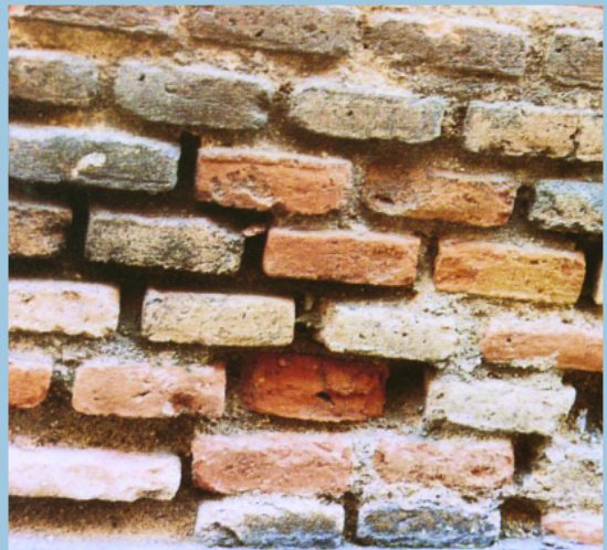
Un aglomerante pobre o utilizado incorrectamente produce la pérdida del mismo y deja las piezas cerámicas mucho más vulnerables a los factores atmosféricos de degradación.
