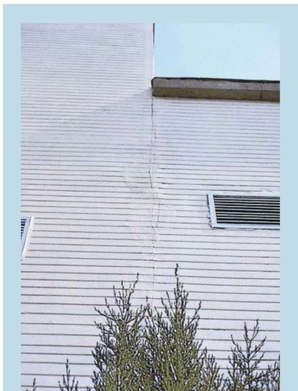
En edificios muy "largos" es imprescindible la inclusión de juntas estructurales y de cerramiento. Intentar que todo el edificio trabaje como una sola viga, a veces, puede ser muy costoso.
