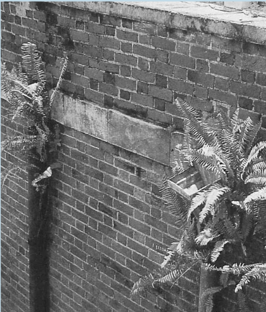
La existencia y retención de humedad en muros exteriores favorecen la proliferación de hongos (arriba) y la aparición de vegetales.
