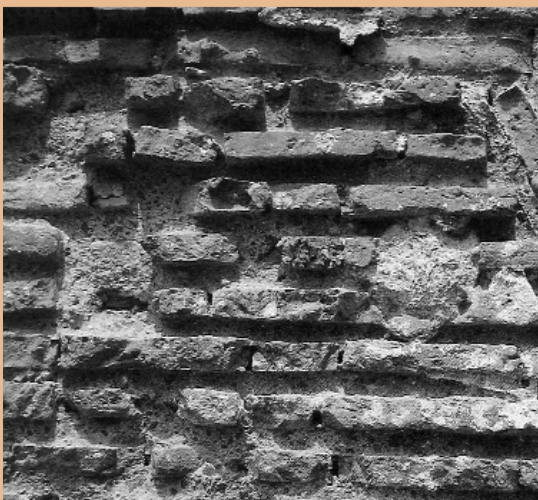
Erosión mecánica de las partículas que transporta el viento sobre el mortero de agarre de este muro de ladrillos.
