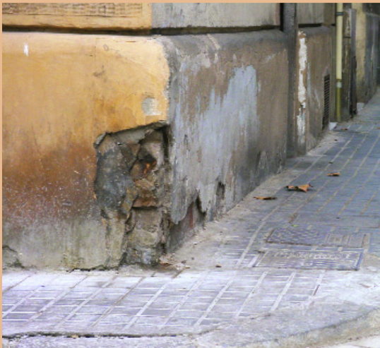
El paso de personas y animales, sumado a la permanente exposición a la humedad atmosférica, ha producido esta erosión mecánica con pérdida considerable del material constituyente.
