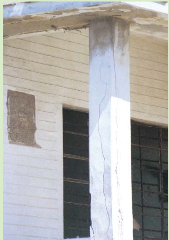
Fisuras características de un pilar sometido a un exceso de compresión.
