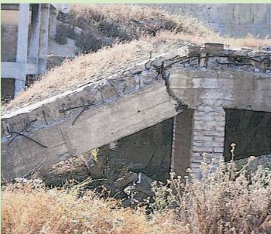
Exceso de carga y rotura de viga de hormigón armado.
