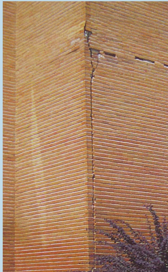
Grietas típicas de los movimientos higrotérmicos. La grieta vertical responde a comportamientos distintos de las caras del muro mientras que la horizontal aparece como diferencia de movimientos entre la estructura portante y el cerramiento de ladrillos.
