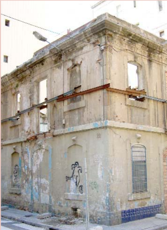
Típica operación de vaciado de un edificio conservando los muros de fachada. Es fundamental el "cosido" de estos muros desprovistos de sus forjados originales de arriostre.
