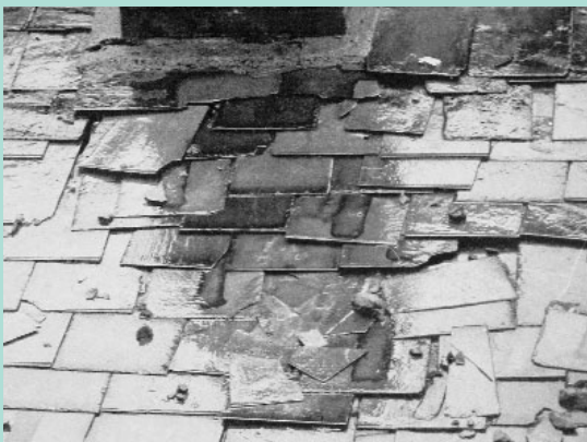
Mala colocación, tránsito indebido de personas o tormentas pueden ser la causa del estado de estas tejas planas. Por supuesto el nulo mantenimiento o verificación periódica del estado de la cubierta genera una situación de riesgo.
