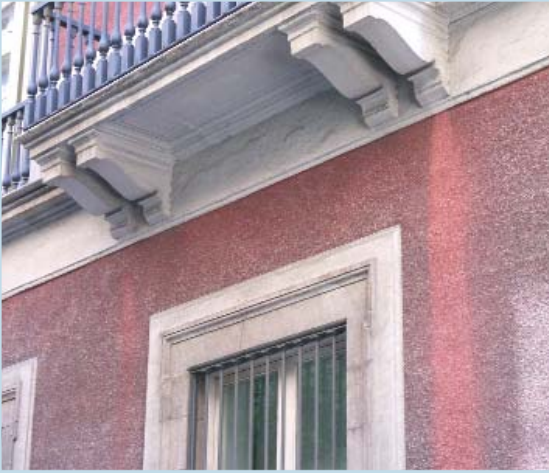
Aquí se aprecia, gracias al color de la fachada, la parte que recibe el lavado de los escurrimientos.
