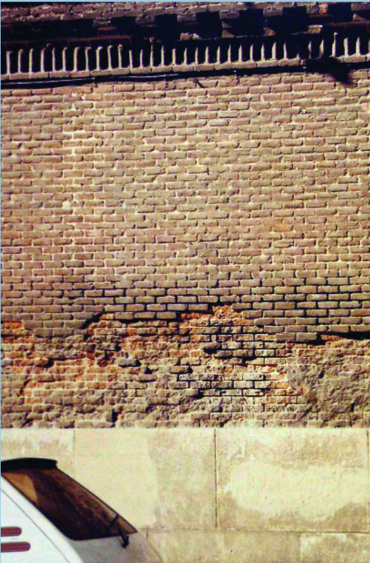
Efecto devastador del ciclo hielo-deshielo en muros de ladrillos.
