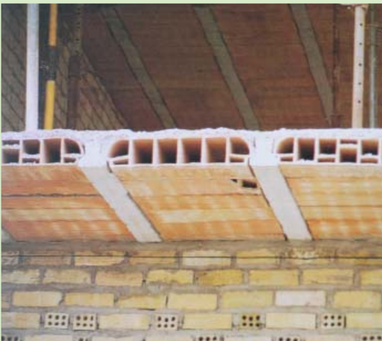
Ausencia de viga de borde en este voladizo de viguetas. Este error constructivo apareja agrietamientos y fisuras múltiples por falta de "solidaridad" estructural.
