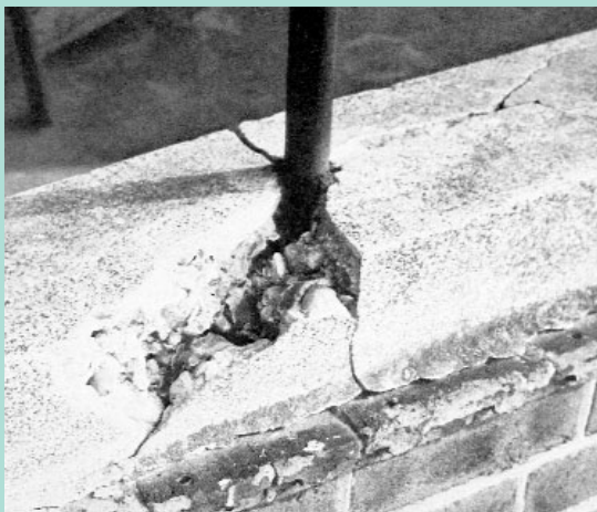
Se ha filtrado agua en el anclaje de esta barandilla metálica, la cual se ha oxidado y provocado la rotura del parapeto que la sostiene.
