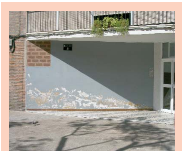
Combinación del deterioro por humedad de cimientos y el "roce" provocado por las personas que circulan hacia el edificio. A pesar de que la pintura es del tipo esmaltado, esto no alcanzó para evitar su descascaramiento.
