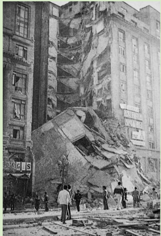
Colapso súbito en una estructura con fallos de cálculo y ejecución.
