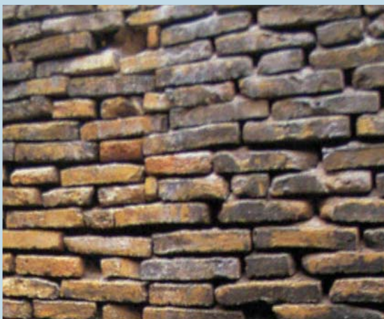
La pérdida del aglomerante entre los ladrillos obedece a varias razones. Las principales son falta de conglomerantes fuertes y la erosión atmosférica.
