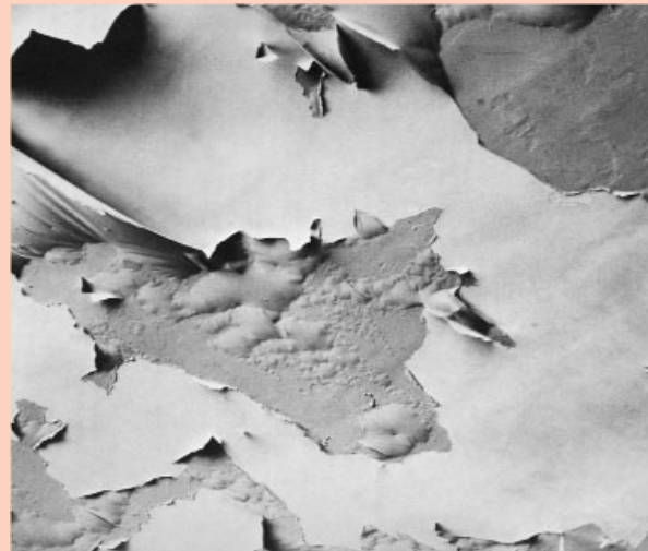
Pintura mal aplicada. No se preparó adecuadamente el soporte.
