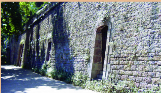
Proliferación de vegetales en muros de piedra. La fuerza de las raíces y la retención de humedad causan roturas, grietas y manchas respectivamente.
