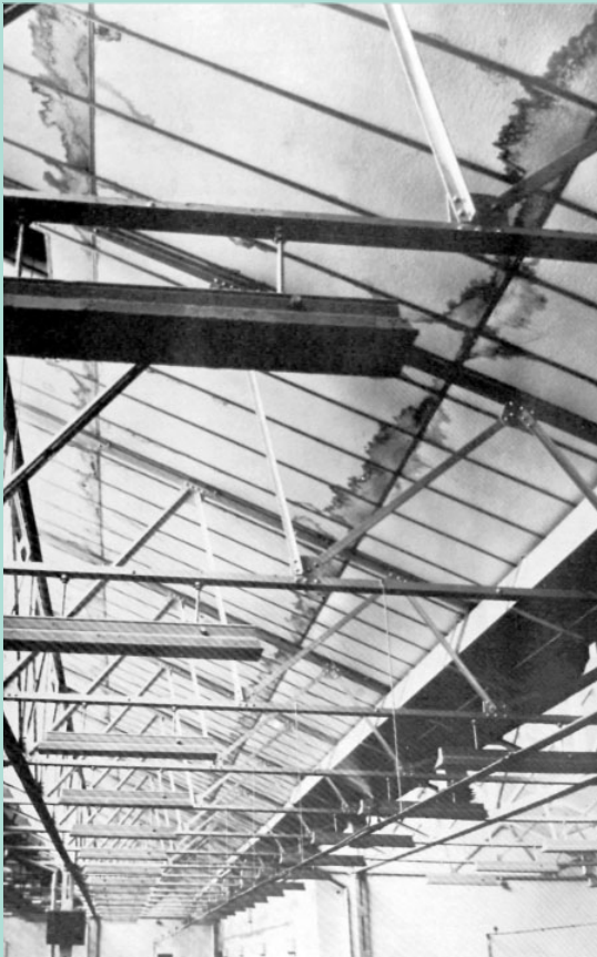
Filtraciones múltiples en esta cubierta de chapa provoca manchas de humedad y suciedad en el cielorraso.
