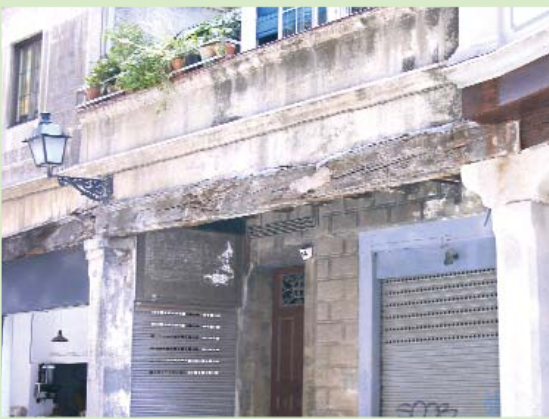
Viga de madera exterior comprometida en sus propiedades mecánicas por la acción de los factores climáticos y el envejecimiento natural.
