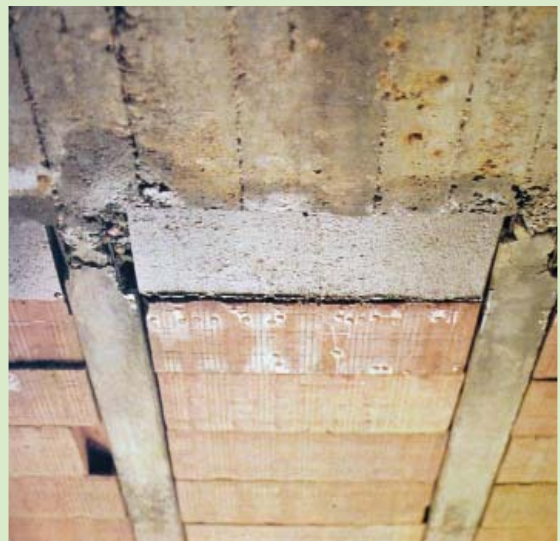
Empalme pobre y mal realizado entre viguetas y hormigón colado in situ.
