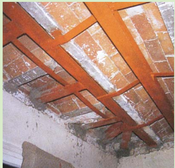
Refuerzo mal ejecutado. Nótese que la viga metálica de la derecha, no está debajo de la vigueta original sino en el medio del revoltón que trabaja a compresión.
