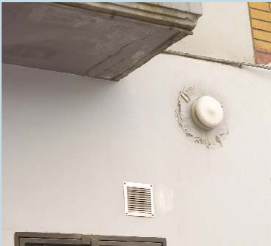
La ventilación de este calefactor, poco o nada aislada, transmite las altas temperaturas y el resecamiento de la pintura circundante.
