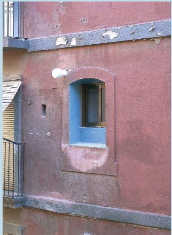
La humedad y los rayos UV han deteriorado la pintura de esta fachada.
