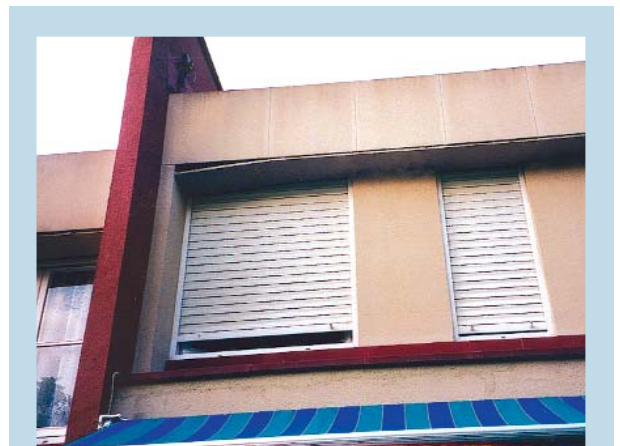
Desprendimiento del aplacado por fallo en el anclaje debido a los movimientos higrótérmicos en una parte expuesta del edificio.
