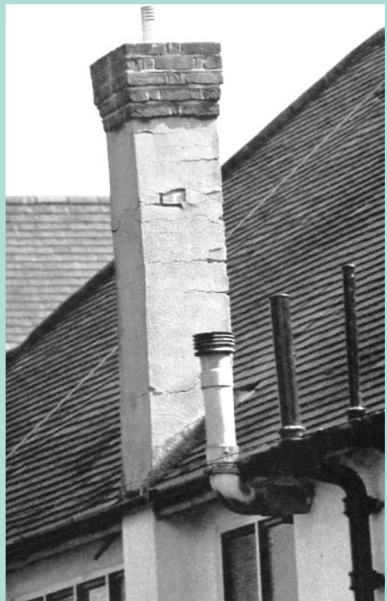
La chimenea de mampostería ha sufrido movimientos. No sólo se registran filtraciones por sus grietas sino también en la base por falta de estanqueidad de los elementos.
