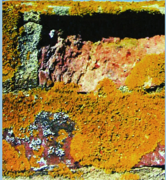
Pérdida de material por la aparición de líquenes que retienen humedad y descascaran el ladrillo.
