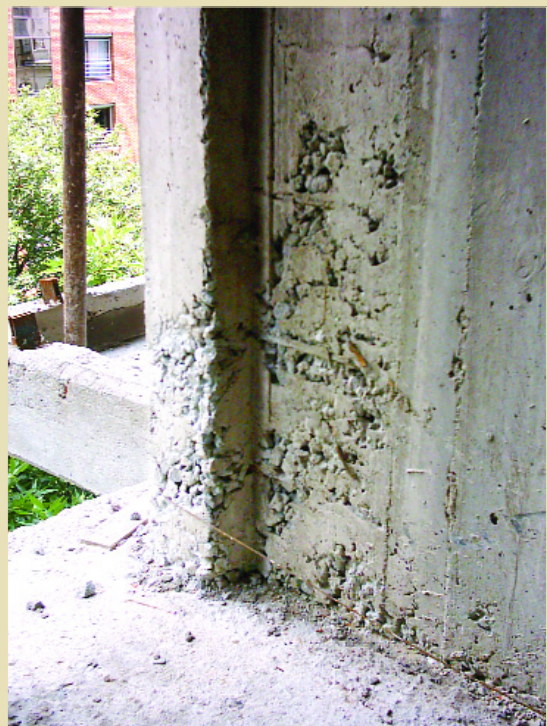
Las coqueras o nidos que se forman en el hormigón son producto de la vibración insuficiente en el momento de su puesta en obra.
