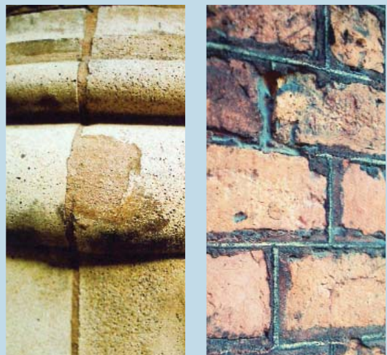
Erosiones químicas y atmosféricas en muro de piedra (izquierda) y ladrillo (derecha).
