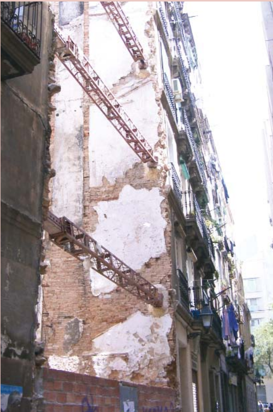
Apeo de muros medianeros. Esta operación se realiza con suma facilidad y es aconsejable cuando las construcciones son de cierta antigüedad.
