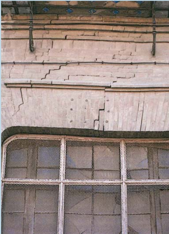
Todo este gran dintel ha descendido apareciendo múltiples grietas y provocando la rotura del acristalamiento.
