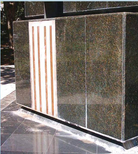
Tres casos en donde los sistema de agarre han fallado: falta de anclaje metálico que colabore con mortero (arriba), escasa rugosidad del sustrato (medio) y mala elección del sistema de amure (abajo).
