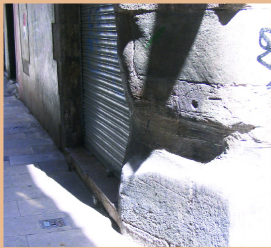
Erosión mecánica por el paso de vehículos sobre las piezas de piedra en esquina en la entrada a una callejuela.
