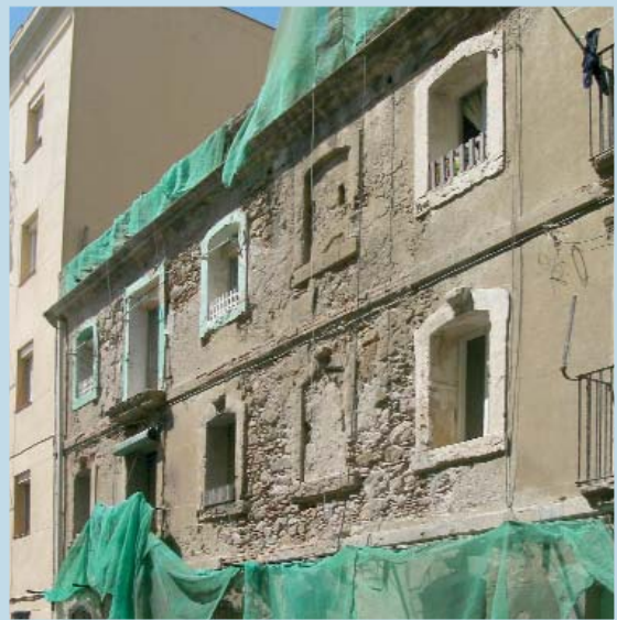
La pérdida de revoco en este muro de piedra es constante y masivo lo cual ha obligado a tomar medidas de seguridad hasta que se inicie su reparación.
