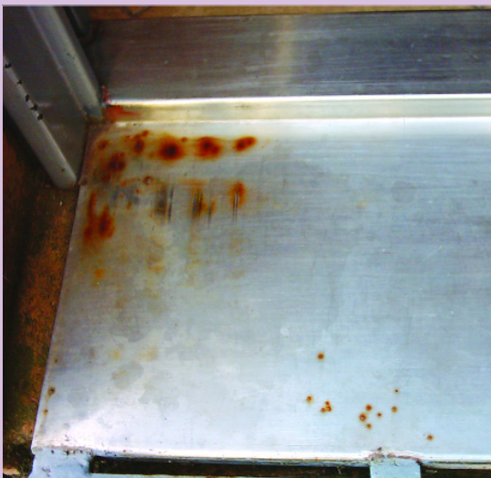
Acero inoxidable atacado por corrosión por picaduras.
