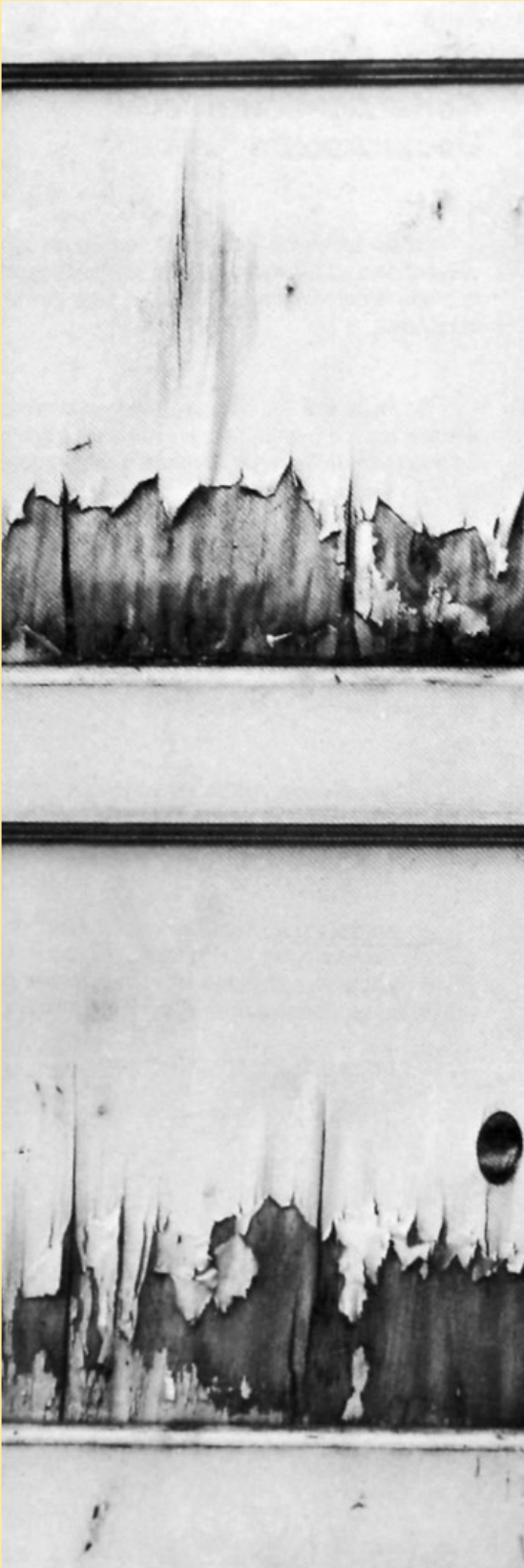
Esta pintura se ha deteriorado permitiendo el paso del agua hacia la madera, la cual se ha hinchado y empezado a desprender el resto de la pintura existente.
