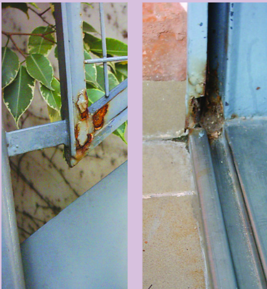
Corrosión por aireación diferencial de elementos metálicos.
