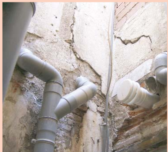
La pérdida en conducciones realizadas de manera incorrecta es una de las causas más frecuentes de la aparición de humedad en los cerramientos interiores.
