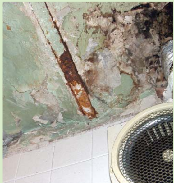
Viguetas metálicas corroidas junto a escape de humos de la cocina.
