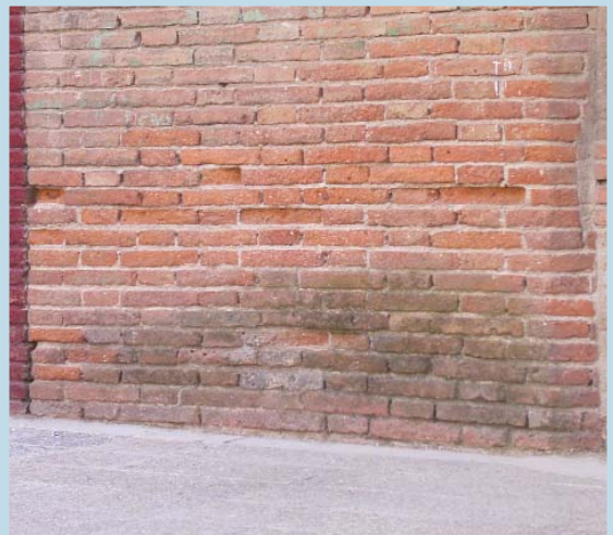
Tres casos de aparición de humedad ascendente desde los cimientos.
