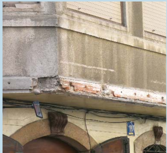
Saltado del revoco en una zona expuesta de un balcón. A veces un mínimo mantenimiento puede detectar los desprendimientos antes de que sucedan.
