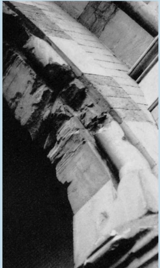
Las piezas pétreas de este arco se encuentran sobrecargadas. Se han producido saltos de material por exceso de compresión.
