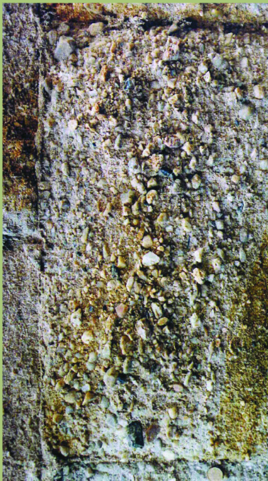
La desagregación granular es una forma de desprendimiento del material pétreo.
