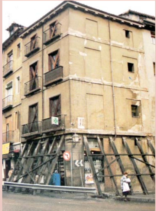
Apuntalamiento de los muros de la planta baja y recuadrado de vasos para evitar deformaciones. Sin duda, estamos frente a una situación estática comprometida.
