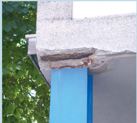
En el caso de revocos que cubren partes metálicas, hay que prestar especial atención a grietas y pérdidas de material. La corrosión a la que posteriormente se exponen estos elementos metálicos es nefasta.
