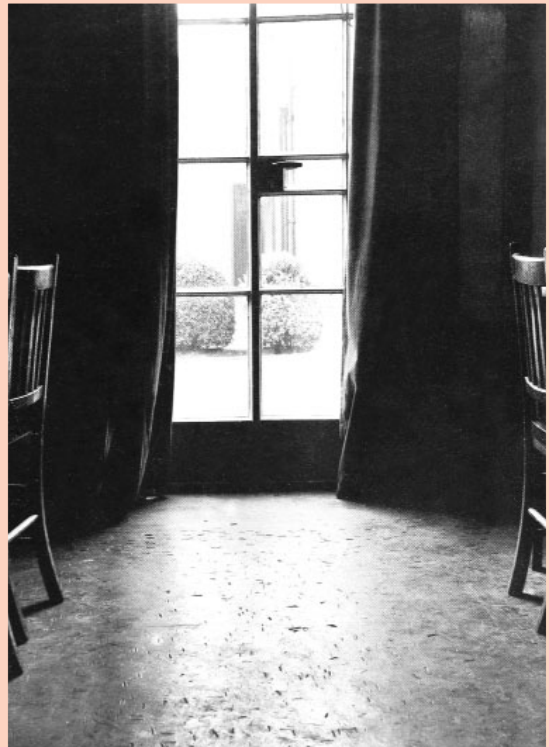
Picaduras en un pavimento de linóleo por el uso de sillas de patas duras y el uso de calzado no apropiado.
