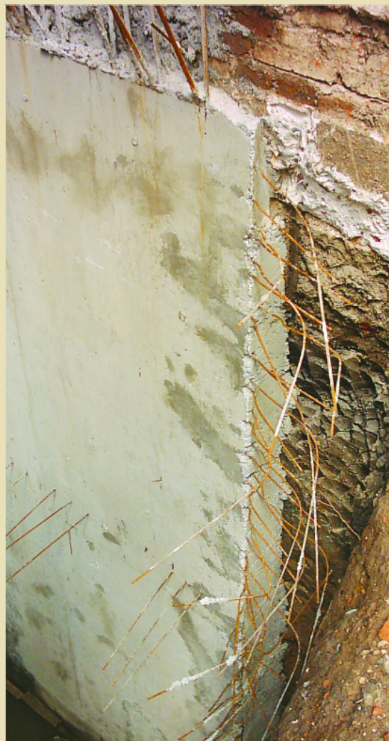
Dos casos de armaduras mal posicionadas: arriba la armadura de una voladizo se encuentra en la parte inferior, abajo las armaduras de la pantalla de hormigón casi no tienen recubrimiento.
