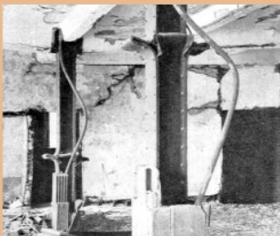
Caso extremo de deformación de estructuras porticadas de hormigón armado: vuelco, aplastamiento y colapso por acción sísmica.
