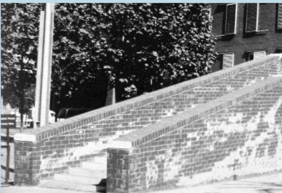
Las eflorescencias son la aparición de sales solubles contenidas en el interior de los ladrillos y transportadas a la superficie de los mismos.
