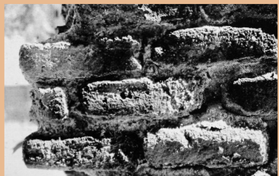
Desconchamiento de ladrillos por acción del congelamiento del agua contenida en los poros del material.
