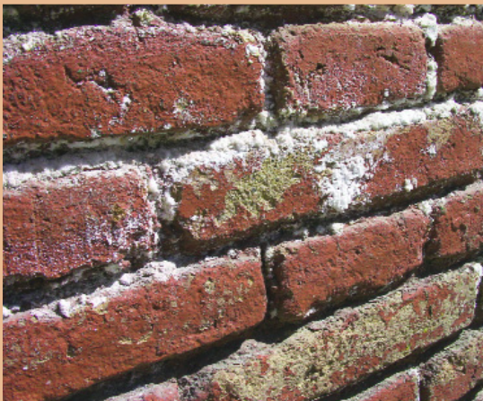
Aparición de eflorescencias en ladrillos. es en las partes más expuestas de las obras de fábrica donde primero efloran las sales solubles.
