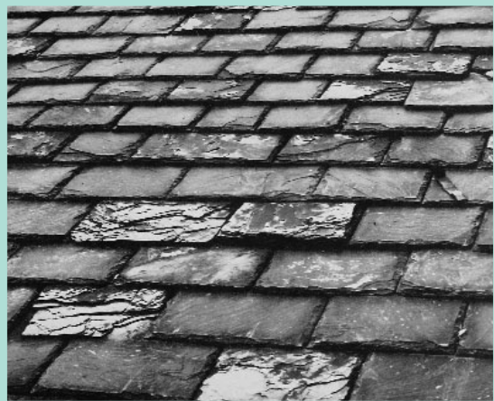
Estas pizarras desconchadas han perdido espesor y peso y por lo tanto es muy probable que empiecen a desprenderse.
