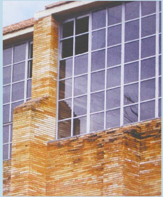
Retención de humedad en salientes y cornisas de muros. La pérdida de material es otra consecuencia de los muros permanentemente húmedos.
