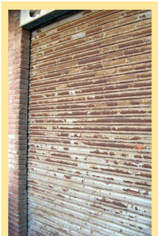
Uno de los peores inconvenientes con las carpinterías de chapa a la intemperie es la oxidación. Hoy en día se está optando por otros materiales como el aluminio, acero inoxidable o al menos chapa galvanizada prepintada.
