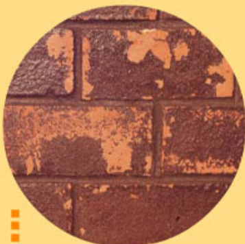
Ladrillo sin protección
