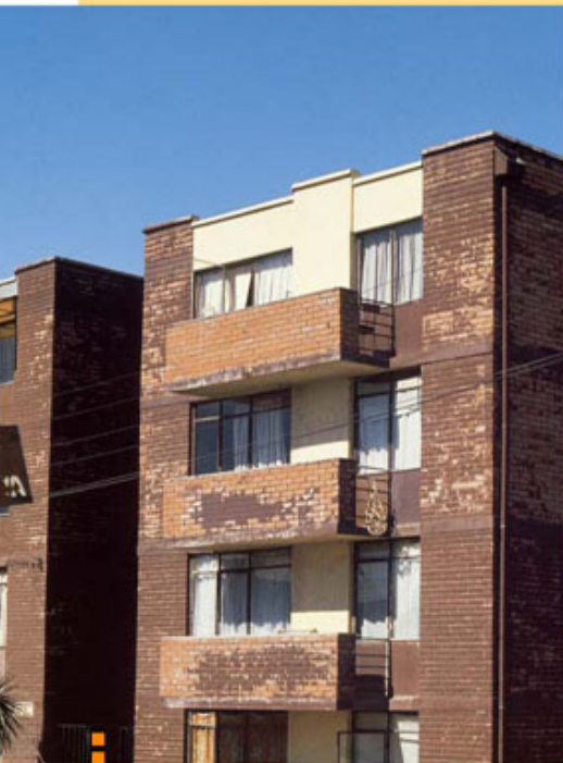
Ladrillo equivocadamente protegido con barniz marino.
