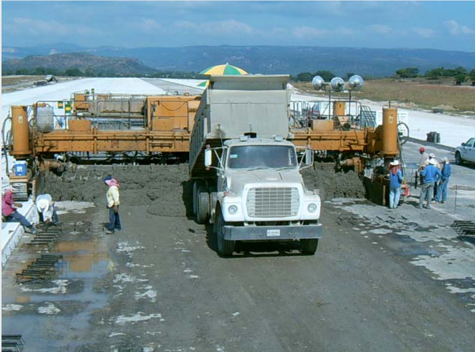
Colocación de la mezcla de concreto para la construcción de la losa
