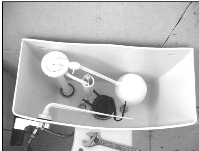
Figura N° 5: Válvula de admisión inferior, 15/16", Elaplas instalada.
