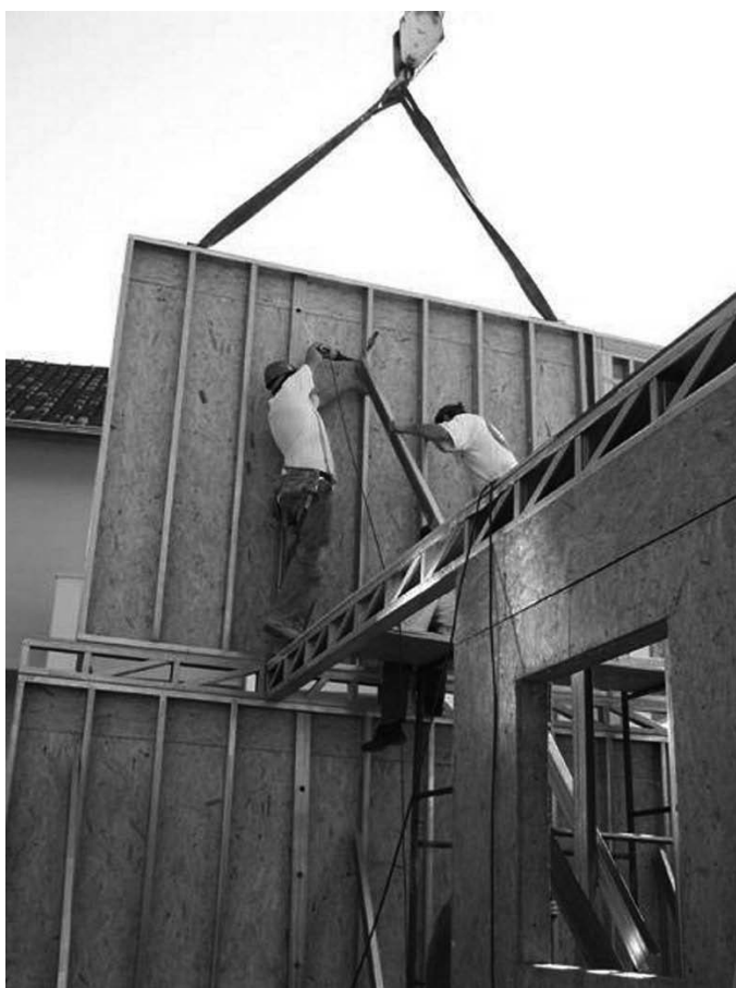
Foto 7.18 - Izamiento y posicionamiento de panel de piso superior. (Fuente: disponible en: http://www.lds.com.br/steel-frame/montaje_023_gr.jpg )
