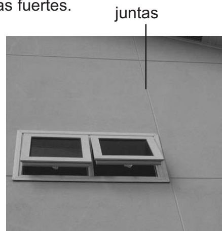
Foto 6.8 - Fachada en OSB revestida con revoque y juntas a la vista para controlar la orientación de las grietas. (Fuente: Archivo Célio Firmo)
