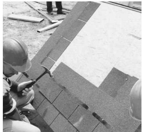
Foto 5.11 - Demostración de instalación de tejas "shingles" sobre placas de OSB. (Fuente: Archivo del autor)
