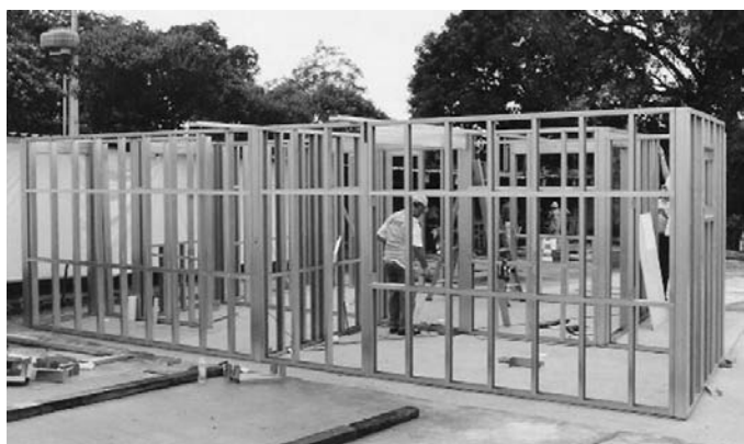
Foto 2.6- Paneles sobre el suelo de tierra de vivienda habitacional Belo Horizonte - MG (Fuente: Archivo del autor)
