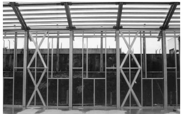
Foto 3.5 - Paneles arriostrados en función de las aberturas en el laboratorio en la Universidad Federal de Ouro Preto. (Fuente: Archivo Célio Firmo).
