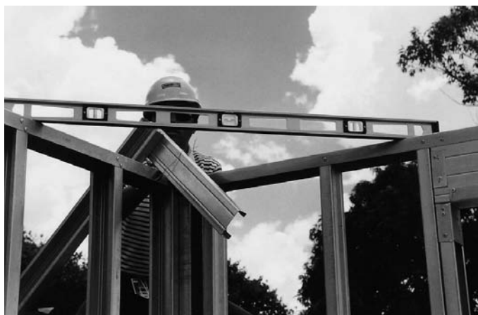
Foto 7.9 - Verificación del nivel del panel y fijación del anclaje. (Fuente: Archivo del autor)
