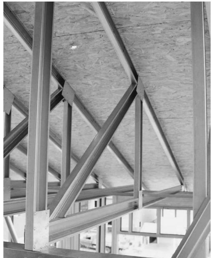
Foto 5.10 - Placas de OSB para la fijación de tejas "shingles" (Fuente: Archivo del autor).
