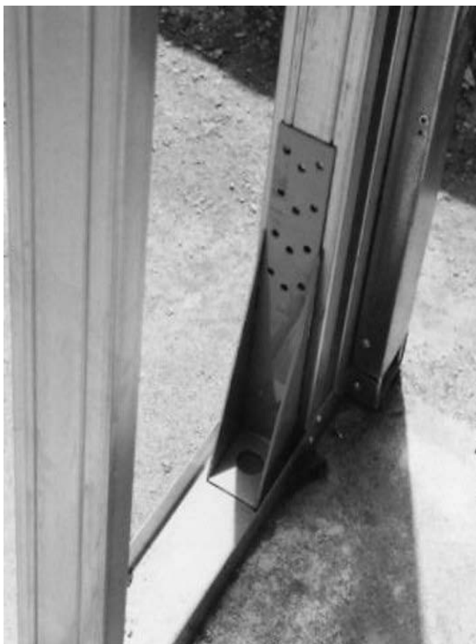
Foto 2.30- Detalle de la pieza de refuerzo en el anclaje de la estructura a la fundación por medio de varilla roscada. (Fuente: Archivo personal)
