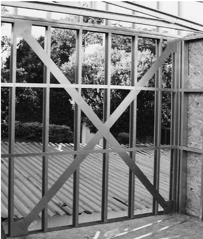
Foto 3.4 - Panel con arriostramiento en "X" Cruz de San Andrés (Fuente: Archivo del autor)
