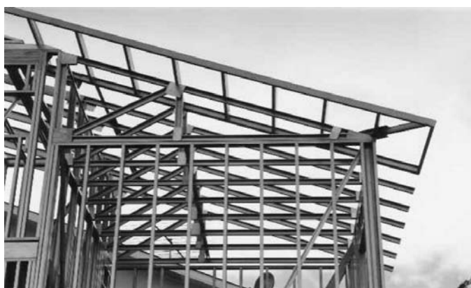
Foto 2.8 - Estructura del tejado de vivienda en Steel Framing. (Fuente: Archivo del autor)
