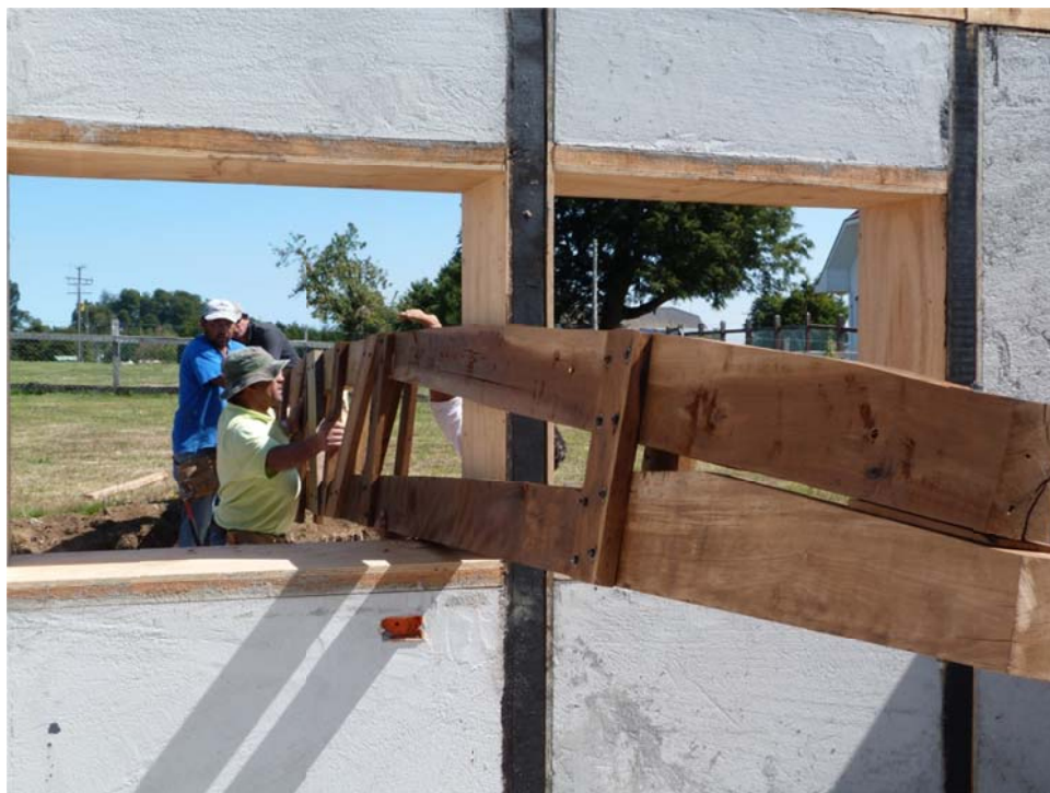
En imagen se muestra el trabajo con maderas recicladas y la instalación eléctrica inserta en Panel.
