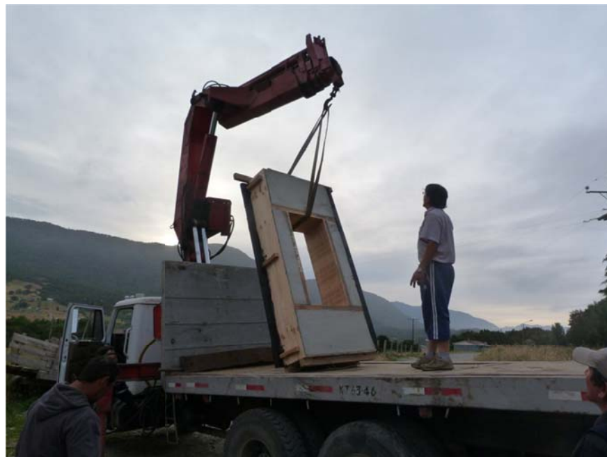
En esta imagen se ve el traslado de los Paneles de fardos de Paja, para ser instalados en Obra.
